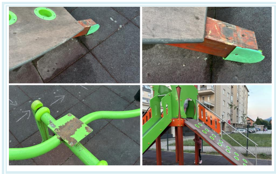
Фотографија 108: Игралште Алексе Шантића 9, - оштећени парковски мобилијар, извор: општина Пале
